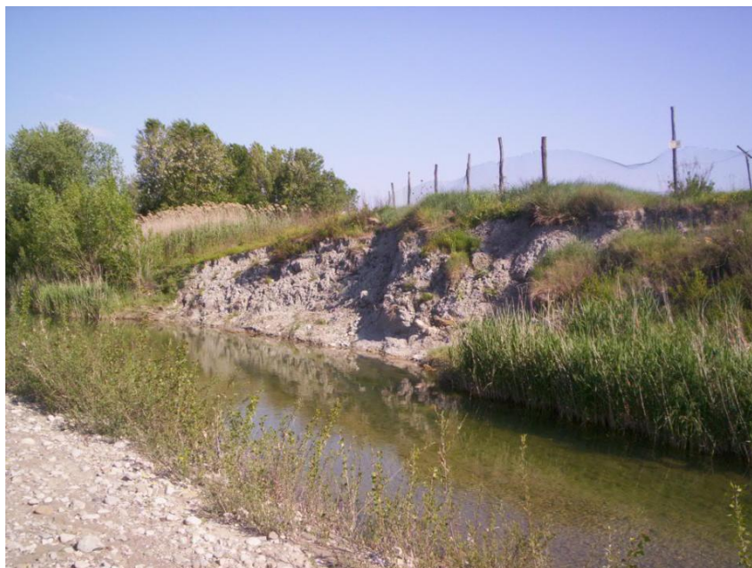
Pennelli con massi contro l'erosione spondale
